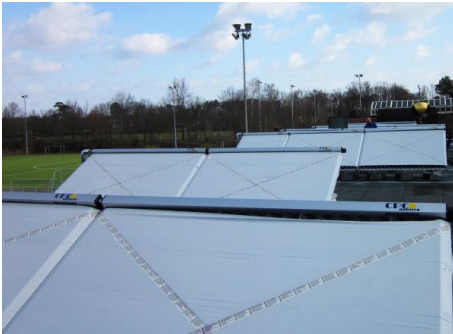
Sportzentrum mit solarer Wärme
