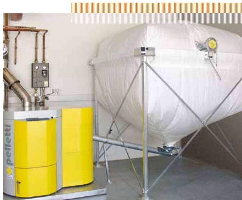
Beispiel für ein Pelletlager mit Gewebesilo und Austragung
